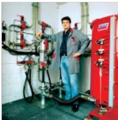
Обеспечение смазочным материалом с помощью контейнерного насоса
