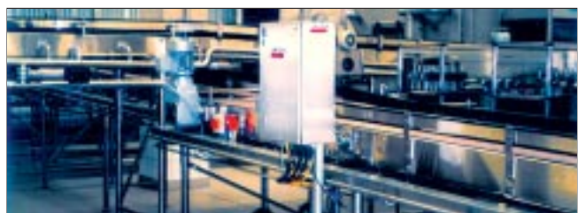
Секция разливочной линии с эжекторным шкафом
